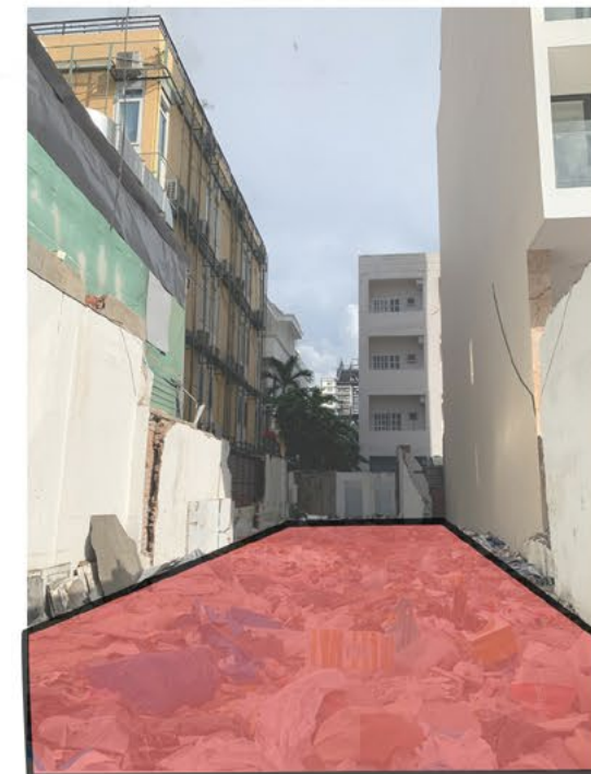
RÁC THẢI XÂY DỰNG LIÊN TỤC
